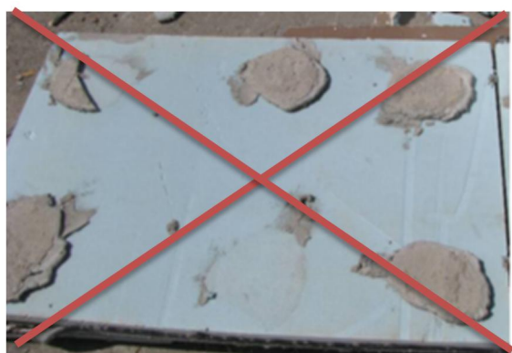
图 15 严禁不涂界面剂直接施工
