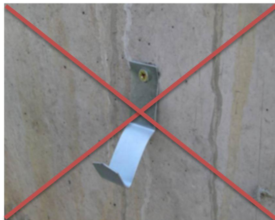
图 25 严禁使用锚固强度不达标扣件
